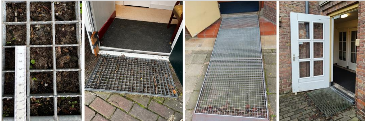
Figuur 2.9 Rooster met te grote gaten die niet zijn afgedekt maken betreden stemlokaal en/of -bureau lastig
