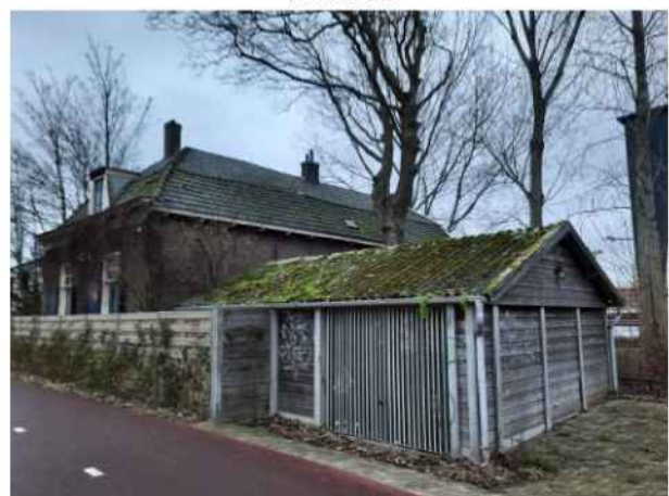
Overzicht schuur. (Visueel geen loden leidingen aangetroffen) Asbestverdachte golfplaten op het dak van de schuur.
