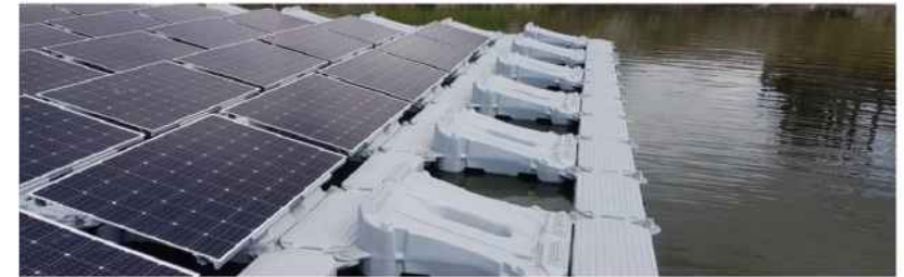
Afbeelding 6. Voorbeeld drijvende zonnepanelen op plastic (HDPE) drijvers.
