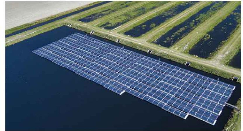
Afbeelding 8. Drijvend zonnepark bij RWZI Everste Koog op Texel, bestaande uit circa 800 zonnepanelen (circa 0,2 MWp). Gerealiseerd in 2016 door het hoogheemraadschap (HHNK), coöperatie TexelEnergie 18 en gemeente Texel. De drijvende zonnepark voorziet de gehele Texelse openbare verlichting van stroom.
