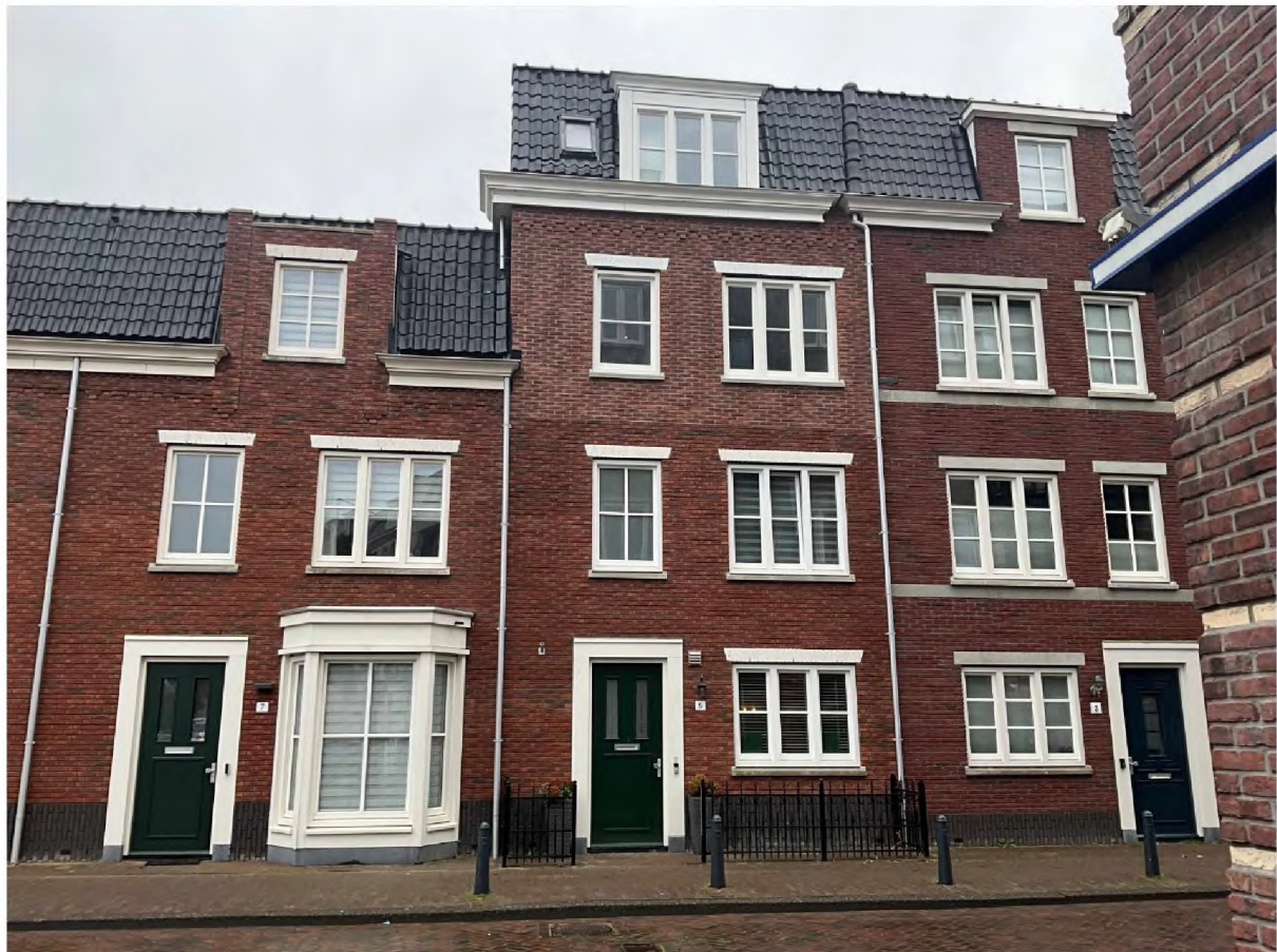
Op bovenstaande en onderstaande foto is de afwijkende voegkleur hwa en goot duidelijk zichtbaar Dakraam links in de dakopbouw is ivm afstanden tot dakranden vergunningvrij
