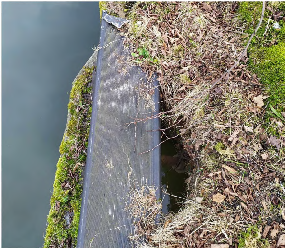
Foto 3. Hier kun je ook duidelijk zien dat de metalen loopplaat beschadigd is en ook los zit. De afwerking is dermate slecht.
