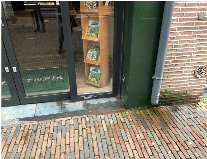
Afbeelding 4.1 Open dakafvoer nummer ■ speelt belangrijk rol in vochtproblemen
