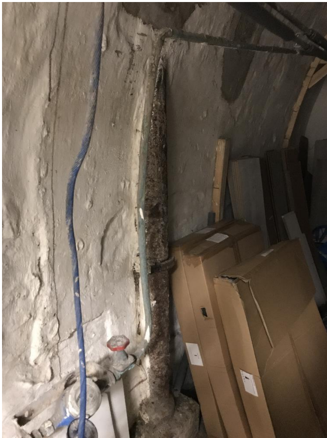
Afbeelding 3.10 Oude, half ingemetselde, standleiding in de straatkelder van Choorstraat nummer ■
