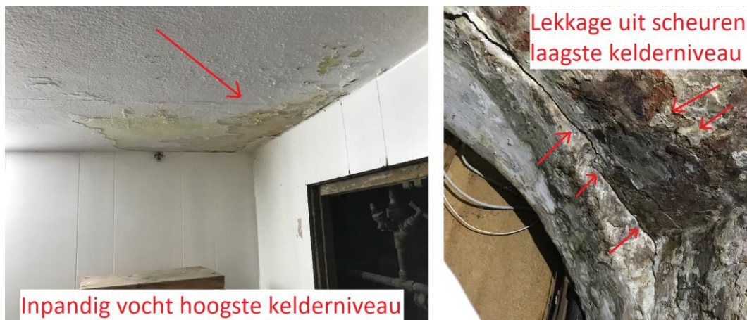
Afbeelding 2.5 Vocht in de muren op kelderniveau -1 en lekkage vanuit scheuren op kelderniveau -2
