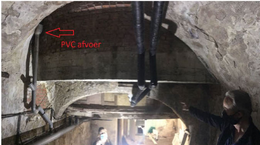
Afbeelding 3.5 Pvc-afvoer in kelder nummer [REDACTED]
