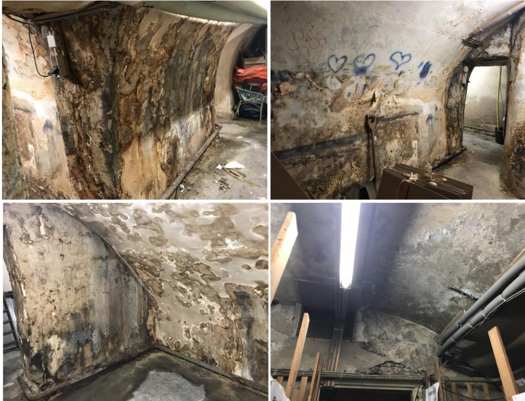
Afbeelding 2.11 Vochtplekken en zoutafzetting op wanden door gehele kelder nummer ■
