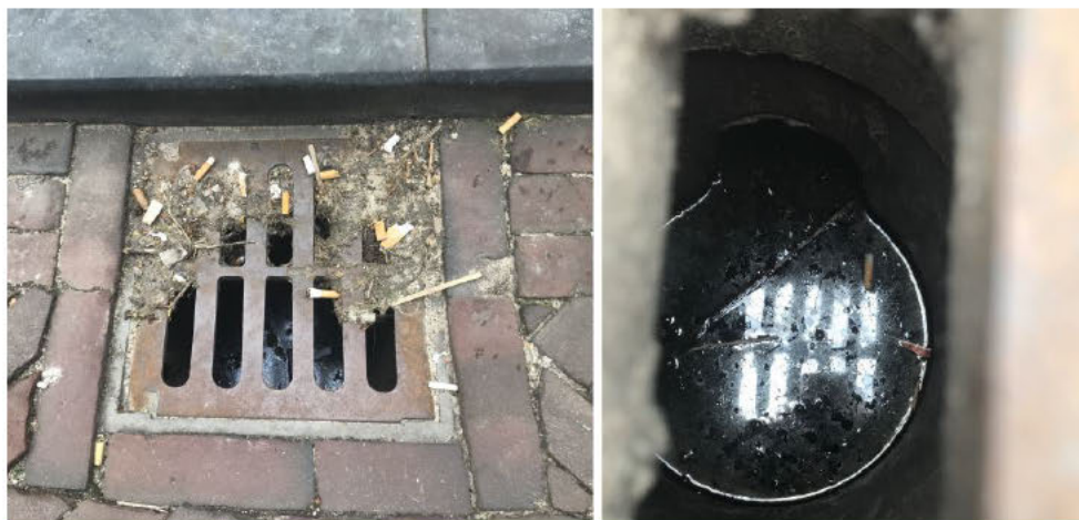
Afbeelding 3.6 Straatkolk, buiten- en binnenzijde
