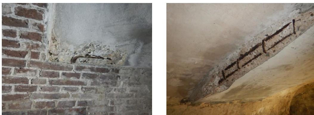
Figuur 3-16: Voorbeelden van betonschade [DRI29A-SCH-002-002 en DRI21A-SCH-001-002]
