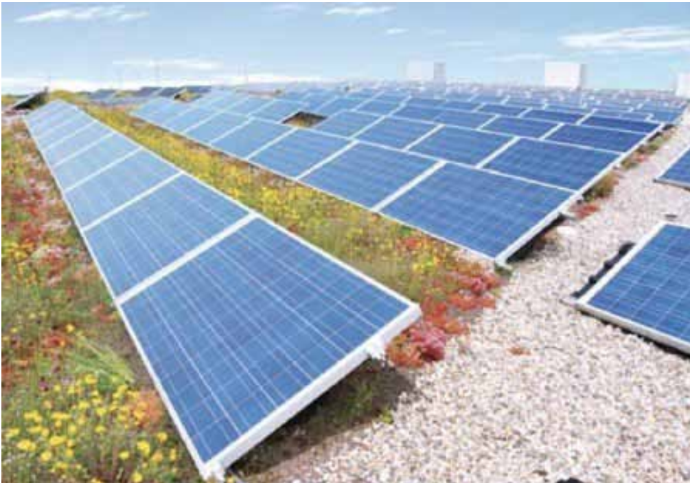
pv panelen op de daken gecombineerd met groen dak
