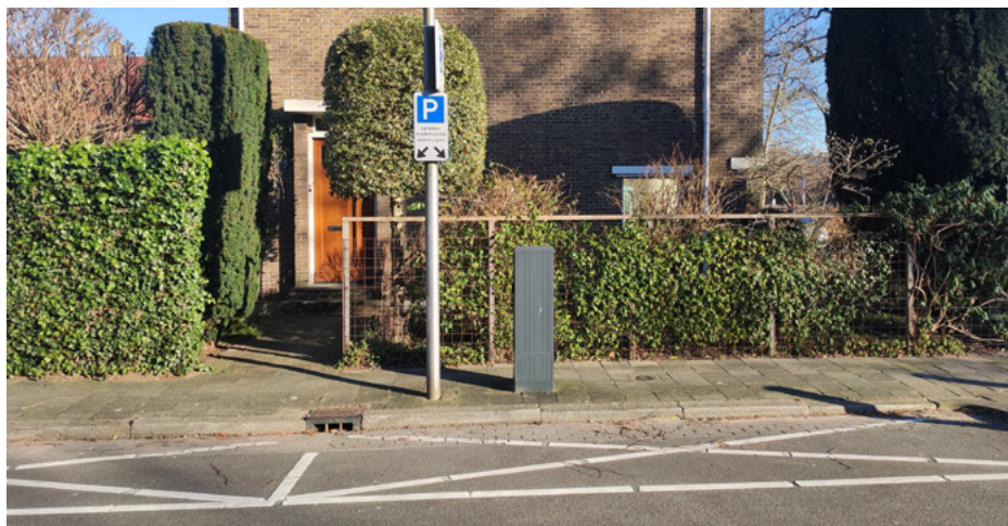
Figuur 1: Publieke laadpaal met netaansluiting
