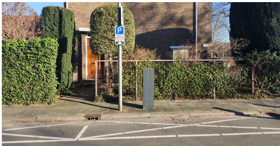
Figuur 1: Publieke laadpaal met netaansluiting
