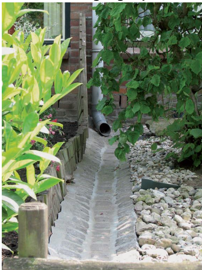
Regenwater via een bovengrondse goot
